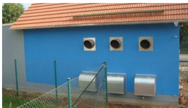
Chronione przed wpływem warunków atmosferycznych przewody odprowadzające i doprowadzające powietrze
